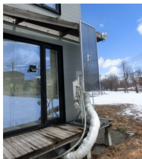
写真2 太陽熱集熱器
