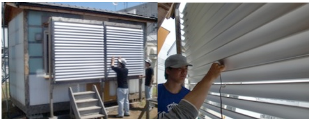
写真6 PCM ブラインド 写真7 背面の状況
